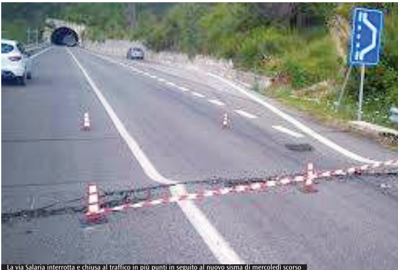
La via Salaria interrotta e chiusa al traffico in più punti in seguito al nuovo sisma di mercoledì scorso
